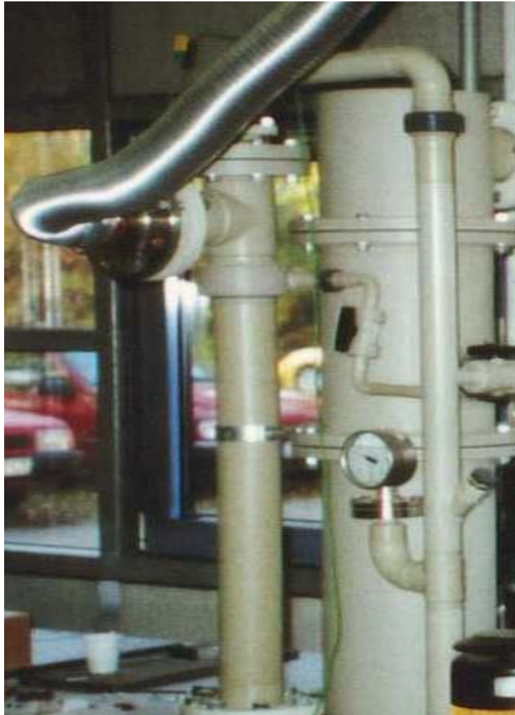
Abb. 12: Ansicht des Gaswäschers
